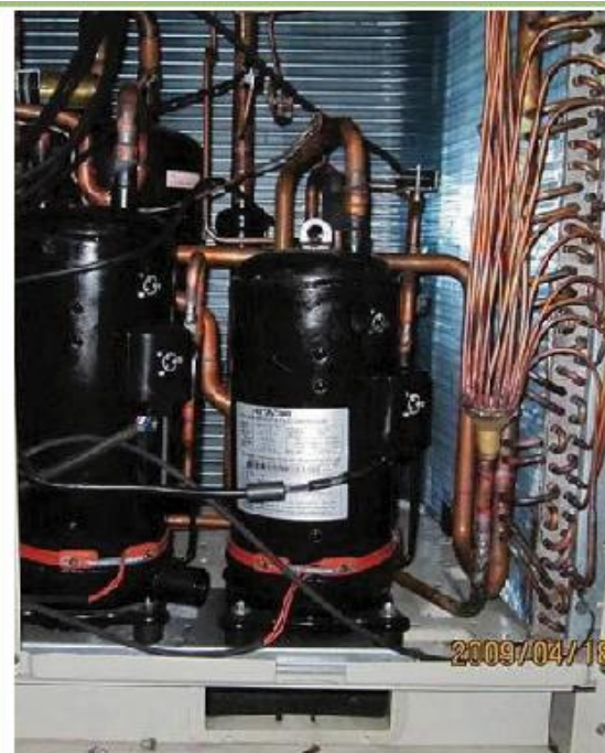
Lako dostupan kompresor, jednostavan cevni razvod, jednostavno odrzavanje
